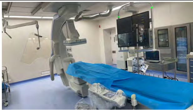
06 手术间内 DSA 装置 (Arits zee III ceiling)
